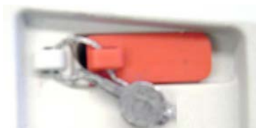
Блокировка включена и опломбирована проволочной пломбой
